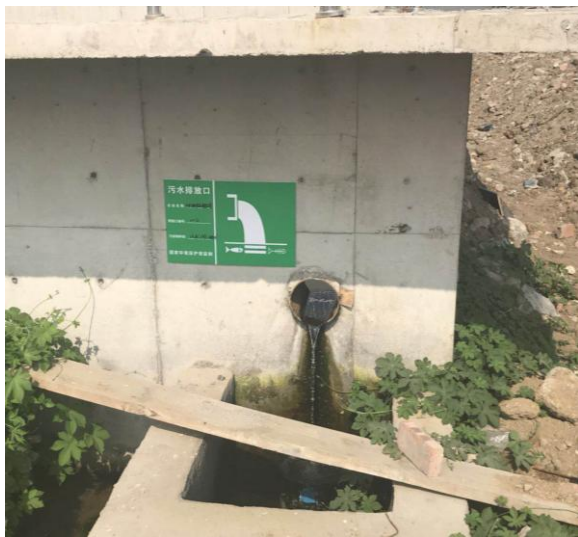
废水排放口标志牌
